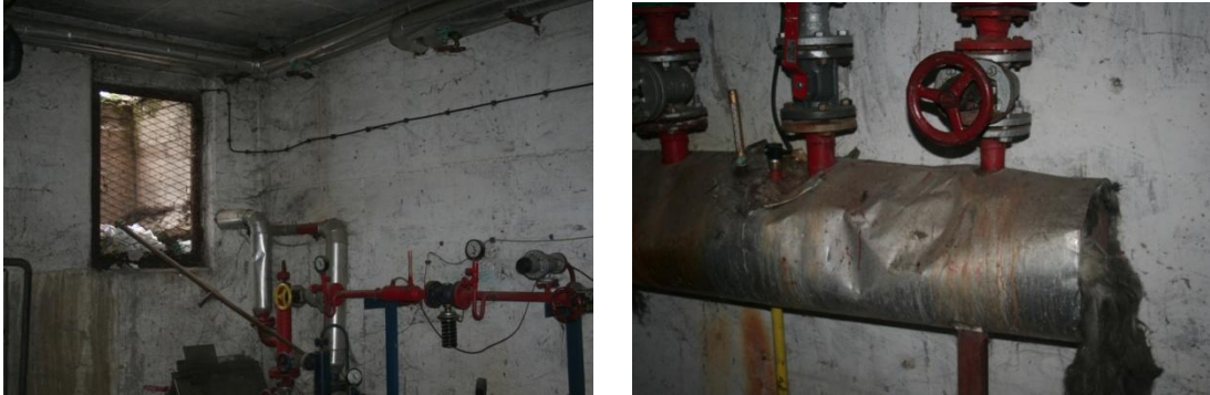
Слика 4. Топлинска потстаница
